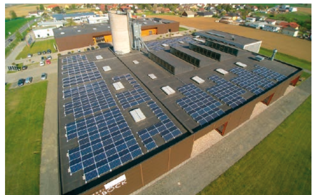
Die beeindruckende PV-Anlage aus der Luft gesehen.
